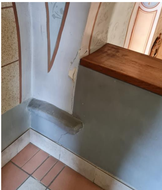
Slika 10. umjereno nekonstrukcijsko oštećenje
