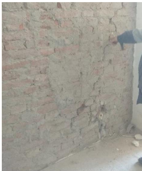
Pukotine širine veće od 10 mm
