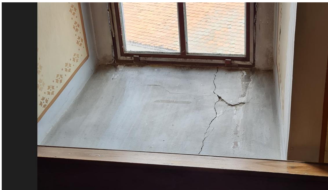
Slika 8. umjereno konstrukcijsko oštećenje
