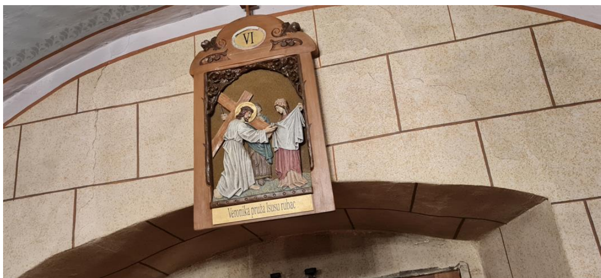
Slika 12. blago nekonstrukcijsko oštećenje
