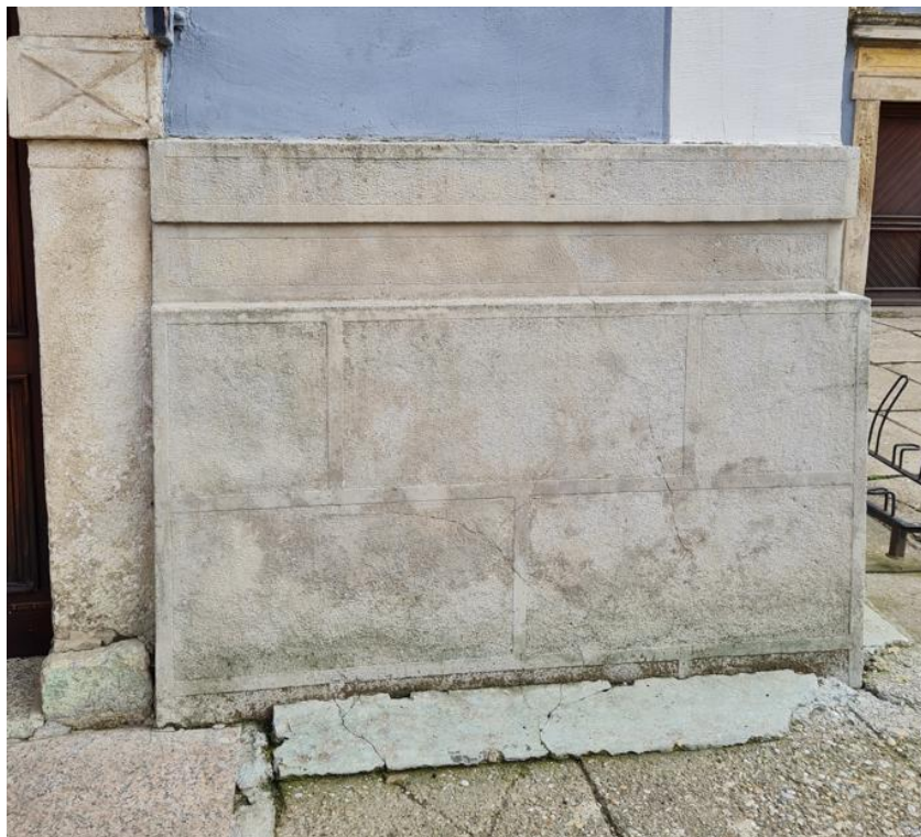
Slika 12. blago nekonstrukcijsko oštećenje
