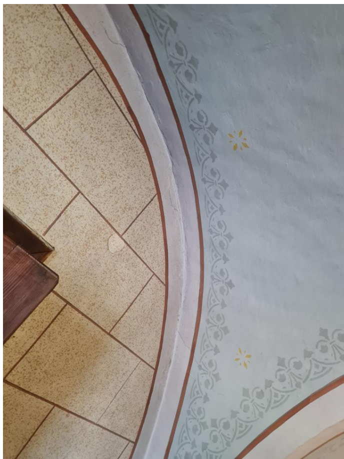
Slika 9. blago konstrukcijsko oštećenje
